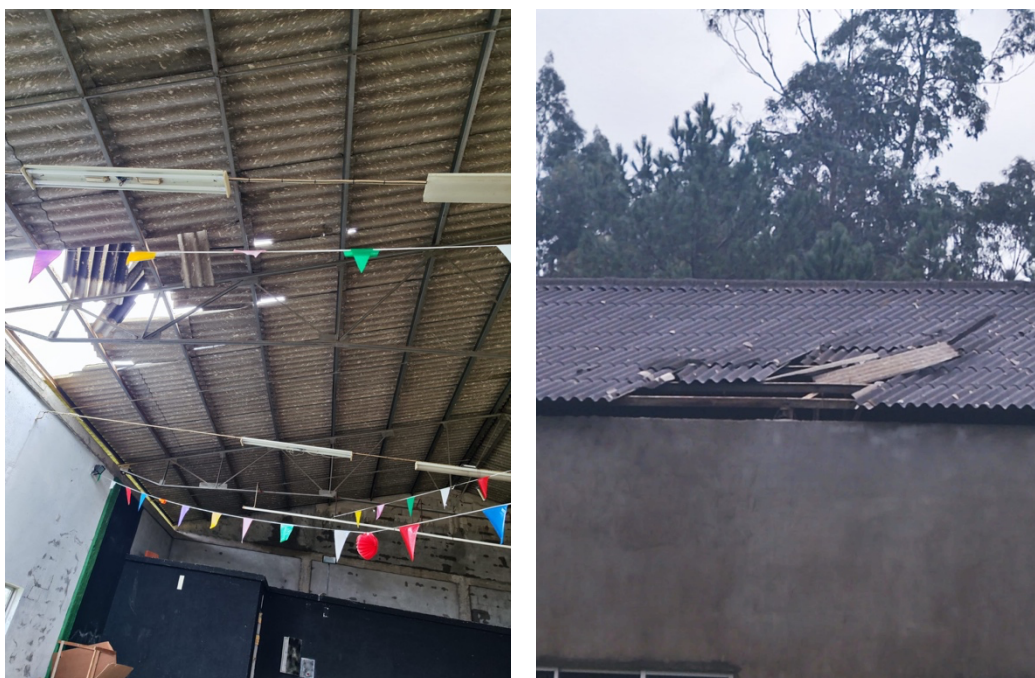
Figura 3 - Danos provocados pela tempestade Kristin na cobertura do Edifício Sede
