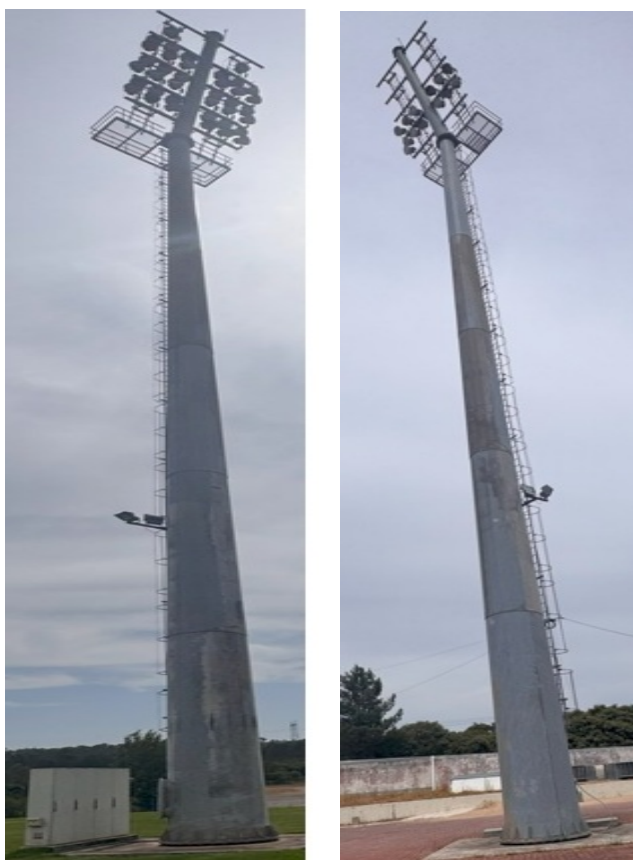
Img. 1 e 2 - Torres de iluminação do campo desportivo.
