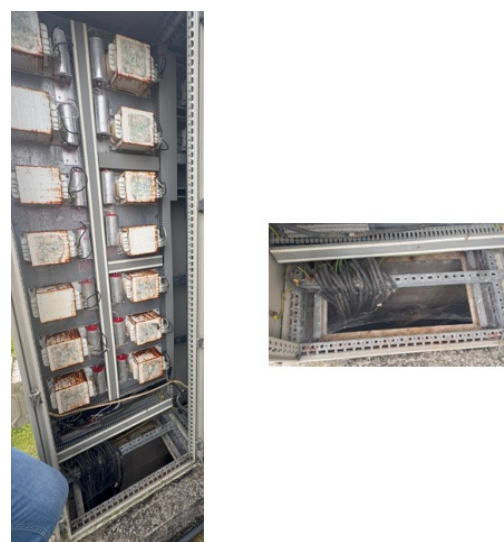
Img. 3 e 4 – Quadros elétricos das torres de iluminação.
